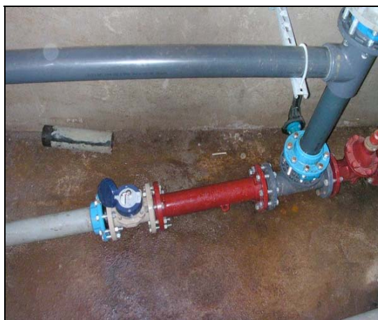
Compteur renouvelé et télétransmis du réservoir village haut DN 80 mm
